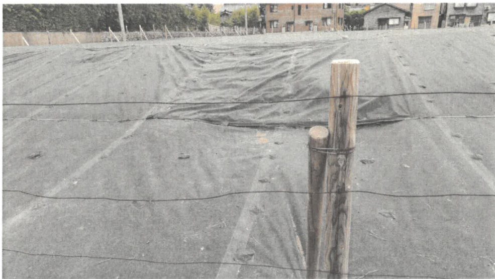
⑥ 砂の流出(南より)
